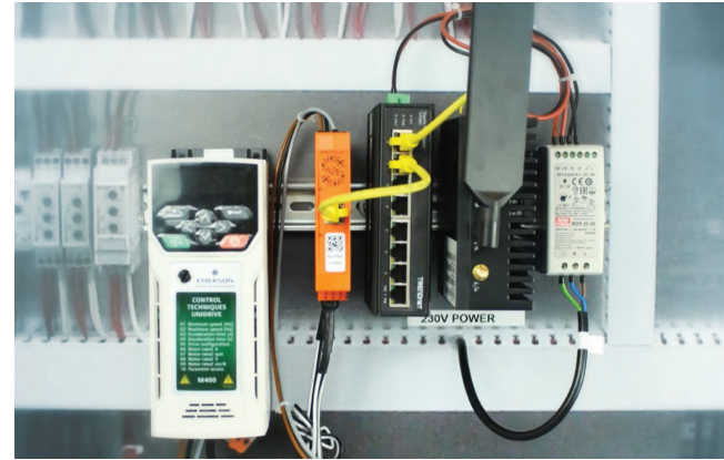
Industrieller Switch TI-PG80 von TRENDnet auf DIN-Schiene als Teil des SAM4 Smart Monitoring Systems installiert.
